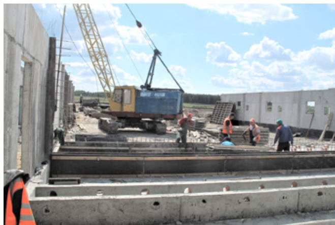
При строгом контроле за сооружением объекта не допускаются никаких отклонений от проекта
